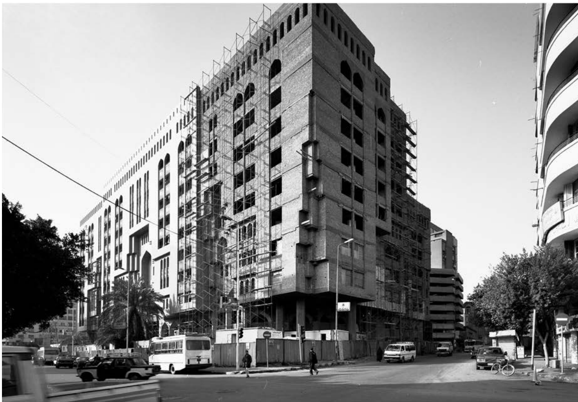
193 - Le nouveau siège de la Banque centrale en cours de construction (2006) rue El Goumouréya 193 - New seat of the Central Bank under construction (2006), El Goumboureya Street
